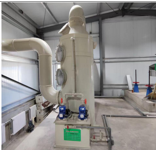
废气处理装置
