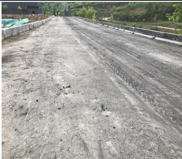
进场道路砂化
