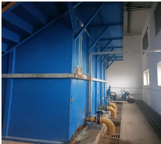
水处理车间内设备
